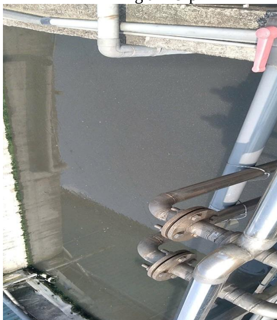
Bể chứa bùn
