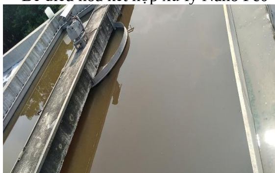
Bể lắng sơ cấp
