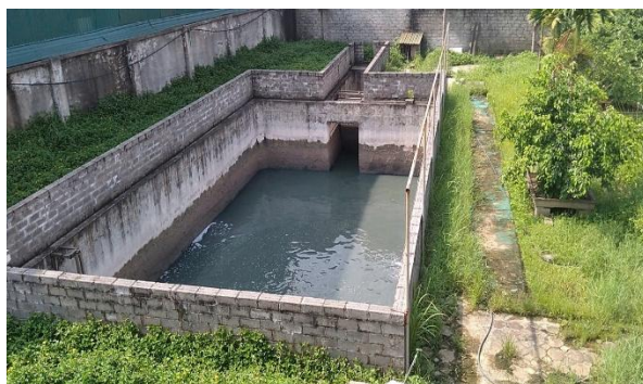
Bể thu gom
